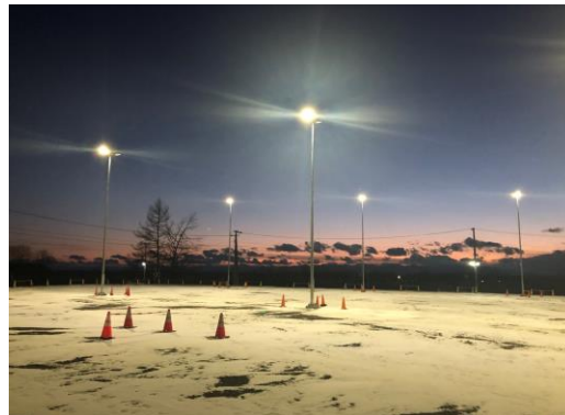
新設した照明灯
